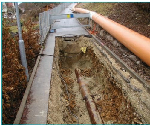
La tubería nueva de SPC DE 500 x 28,4 mm esperando el tiro. Se reconoce fácilmente lo estrecho de la obra y la tubería vieja DN 300
