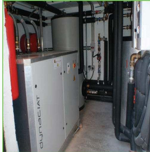
Vista interior de sala de maquinas(70kw).
