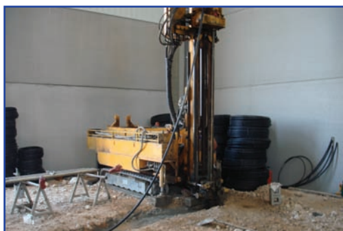
Equipo de Perforación para la ejecución de los intercambiadores verticales
