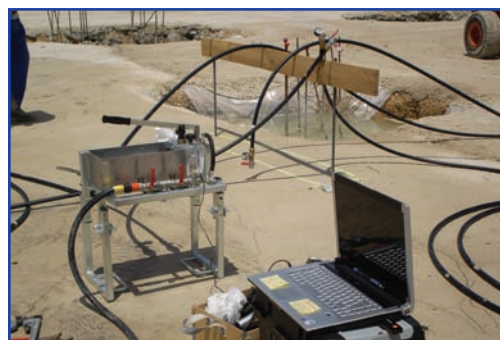
Equipo de control de presión
