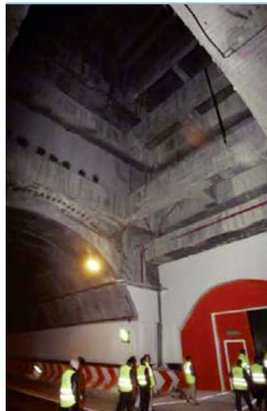
Pozo de extracción masiva de humos
