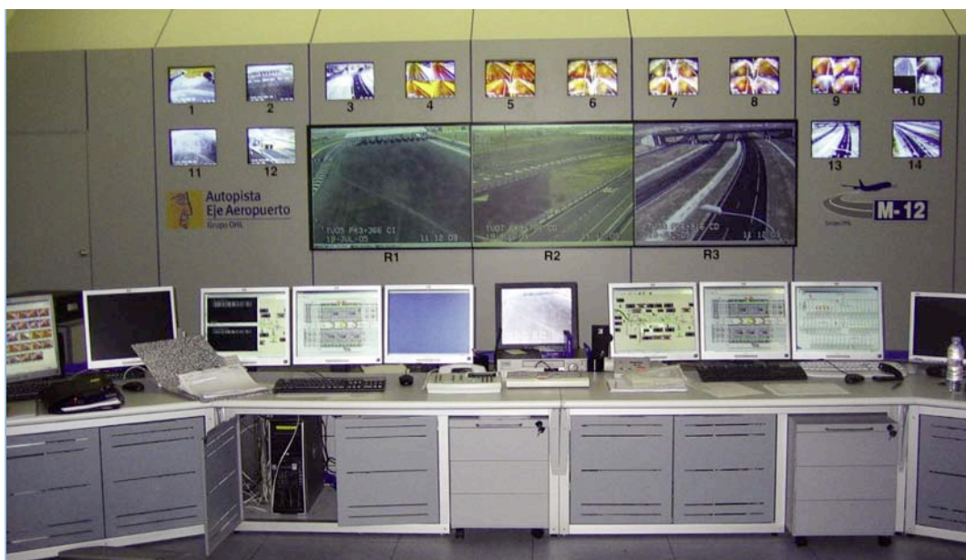
Centro de Control del túnel y de la autopista M-12
