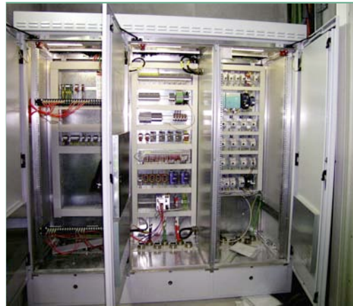
Armario de Control Distribuido de Túnel (Calle 30)
