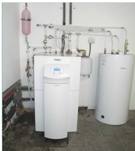
Bomba geotérmica, acumulador y uno de los colectores para el suelo radiante
