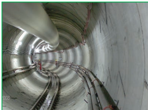
Sistema de transporte en el túnel
