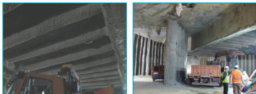
Fotos 33 y 34. Vista de la estructura de apeo de la galería gunitada.
