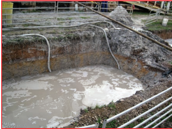
Balsa de decantación
