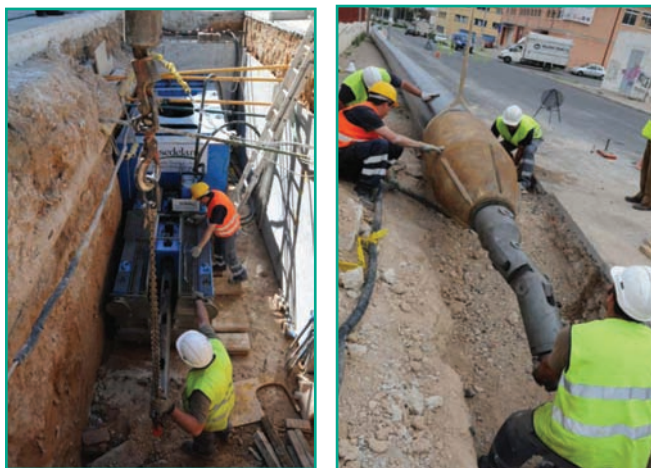
Izda.: Plataforma en cata de ataque terminado la operación de empuje de las barras Dcha.: Acople del cabezal de rotura junto con tubería en barra de tiro antes de la sustitución
